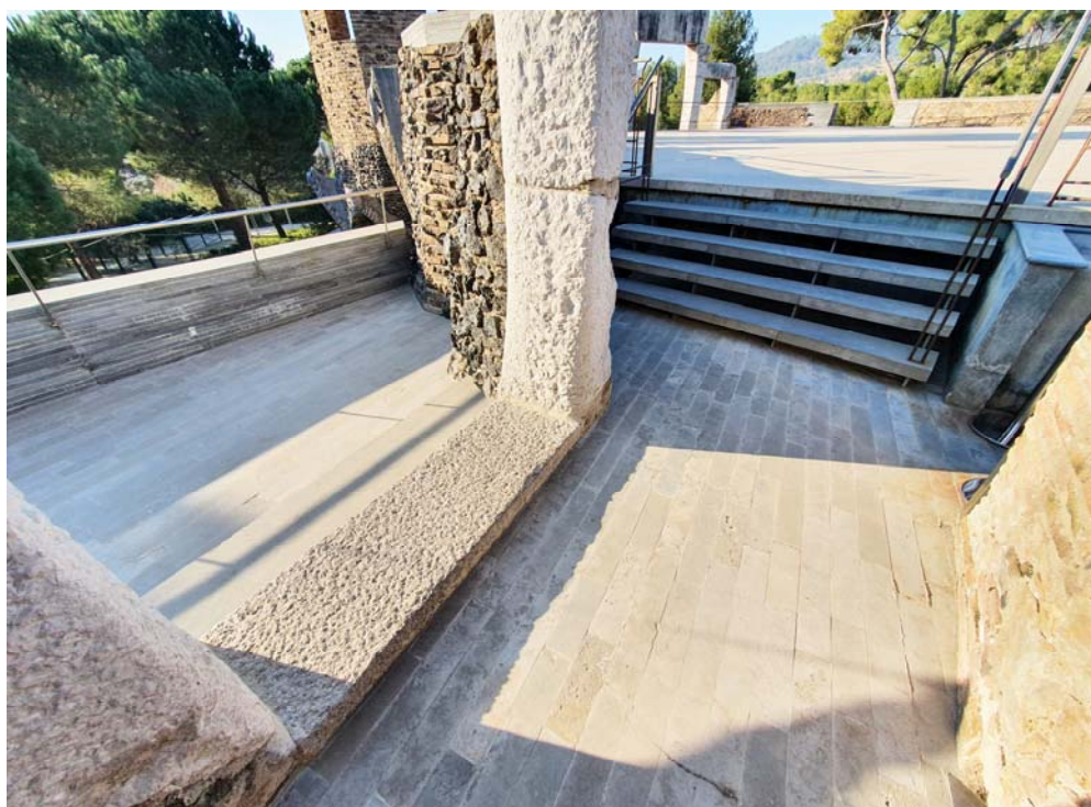
B2 06 – L'accés a algunes parts del recinte de Cripta, com el de la terrassa de la coberta, presenten actualment determinades barreres arquitectòniques que fan que no resultin accessibles a persones amb mobilitat reduïda
