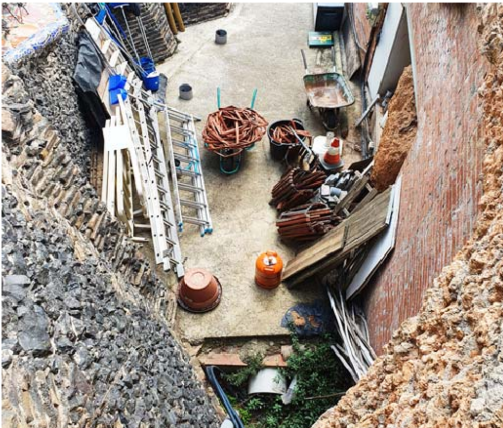
B2 07 – La manca d'espai disponible com a magatzem dintre del recinte de la Cripta, fa que actualment s'utilitzin per aquesta funció espais com el fossat lateral, cosa que afecta molt negativament la imatge del monument
