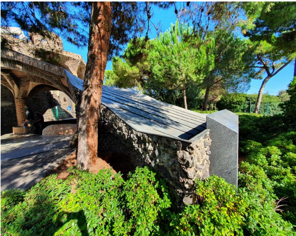
B2 03 – El cobriment amb una coberta de planxa de zinc de l'escalinata d'accés al nivell superior de l'església, junt amb un enjardinament del tot inadequat del seu entorn, dificulta la lectura i correcta comprensió de la seva funció original
