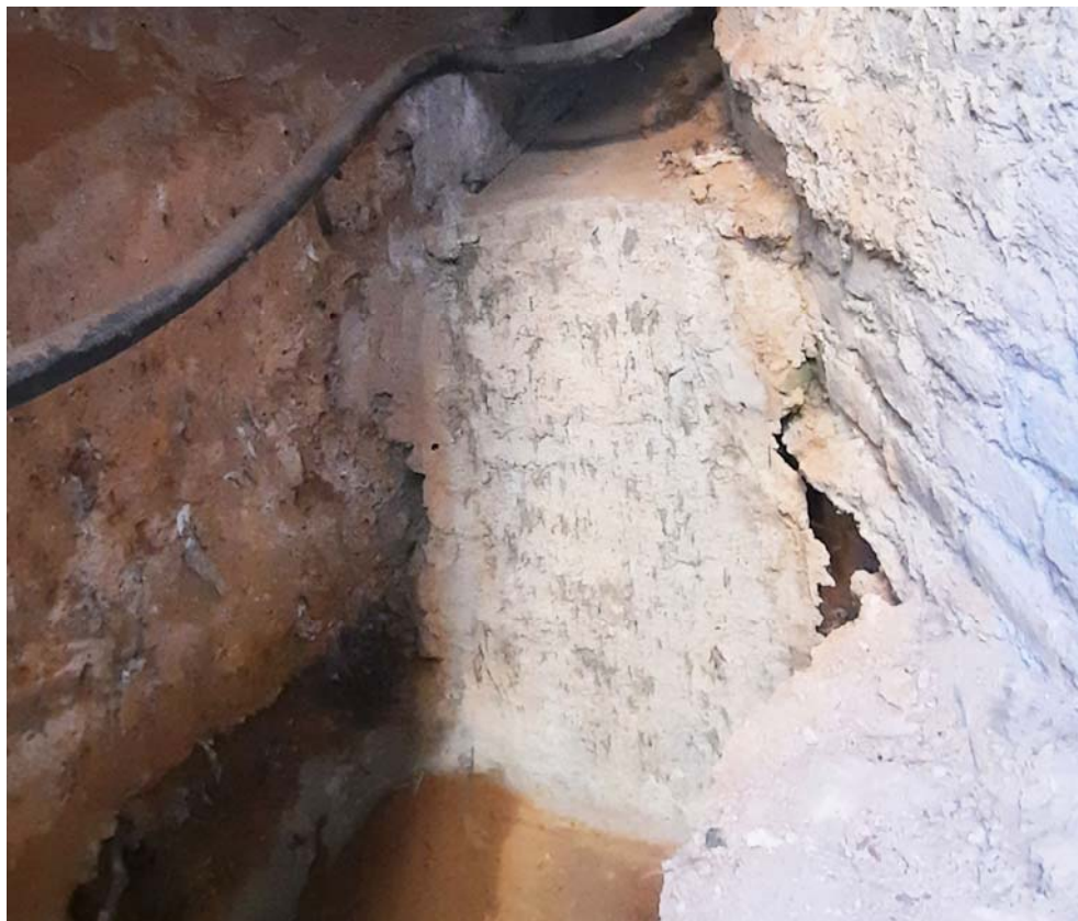
B2 05 – Encontre a diferent nivell entre canals de drenatge al fons del fossat lateral de ponent. La seva mala resolució fa que es produeixin filtracions al terreny i que el mur de maó de la Cripta estigui lleugerament descalçat
